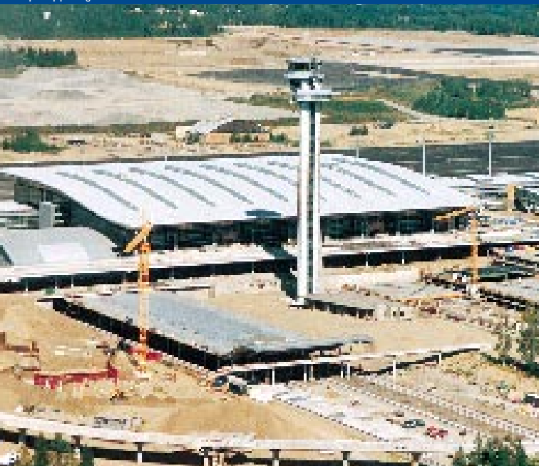
NCCs norska dotterbolag NCC Eeg-Henriksen bygger den nya terminalbyggnaden till Oslos nya flygplats.
