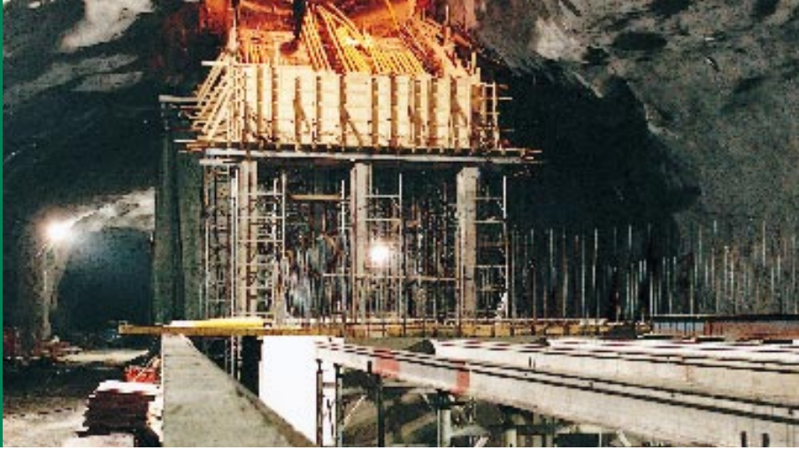
Direkt under terminalerna på Arlanda, byggs tre stationer, två för Arlanda Express och en för genomgående trafik.
